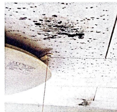
天井にはえたカビ 2月17日、宮城県石巻市の仮設南境第3団地(大林福三郎さん宅)
